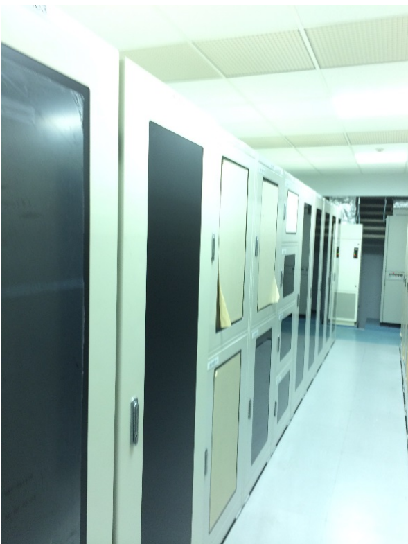
図4 デモ用データセンター写真
